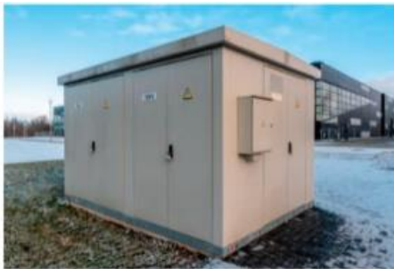
Slika 8.6 Lokalna niskonaponska trafostanica
