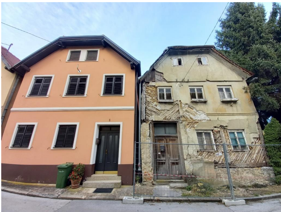
Sl. 11. Primjer ruševne i obnovljene barokne građanske jednogkatnice
