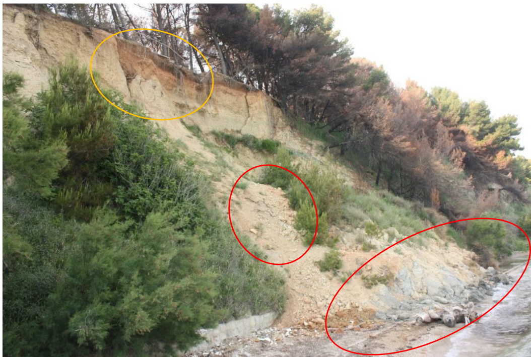
Slika 37. Područje gravitacijskog kretanja materijala na dijelu klifa Duilovo uz betoniranu plažu, svibanj 2018.
