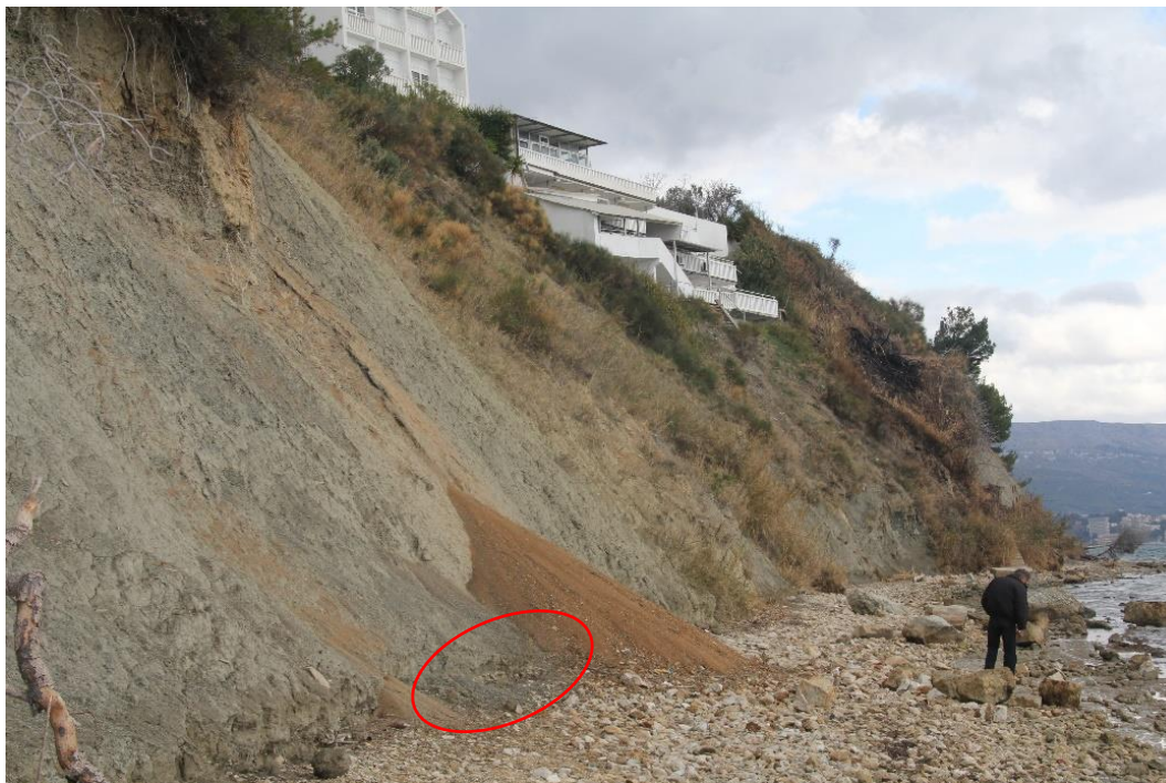
Slika 47. Dno klifa ispod kuće, prosinac 2017.
