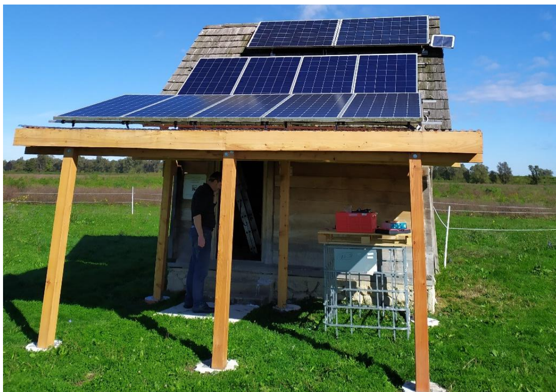
Slika 1.3 – Solarni paneli na krovu kontrolne kuće.
