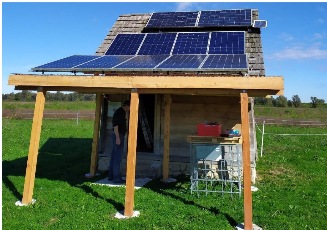
Slika 1.3 – Solarni paneli na krovu kontrolne kuće.
