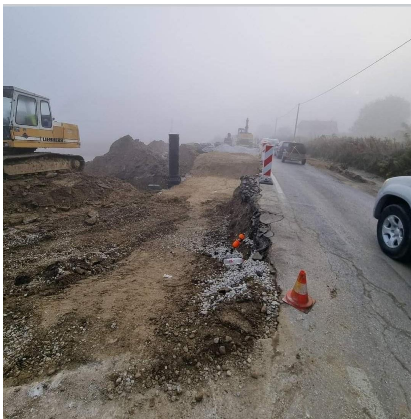
Sl.9. Oštećenje prometnice zbog aktivacije klizišta u općini Bednja
