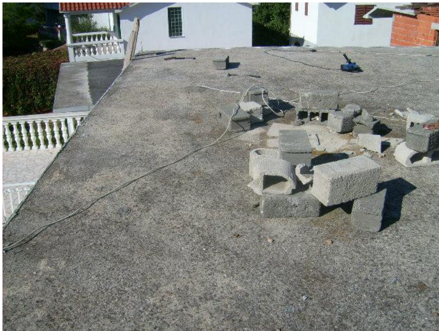
Slika 5. Dio ne očišćenog ravnog krova
