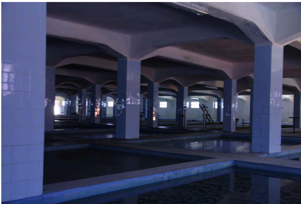
Slika 3. Niz bazena za taloženje na izvoru podzemne vode sv. Ivan u Buzetu u Istri
