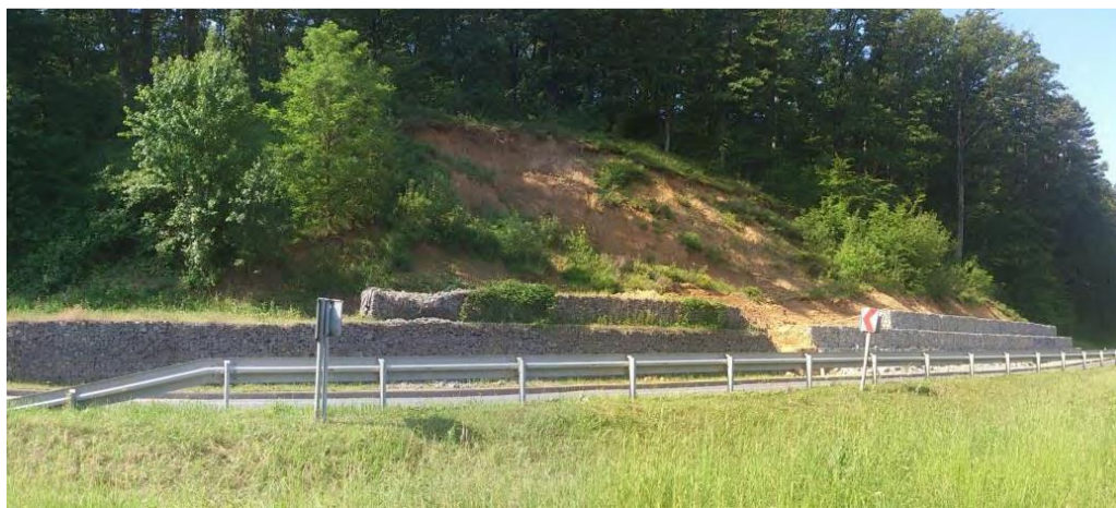
Slika 3. Sanirano klizište na državnoj cesti D2 Našice-Orahovica
