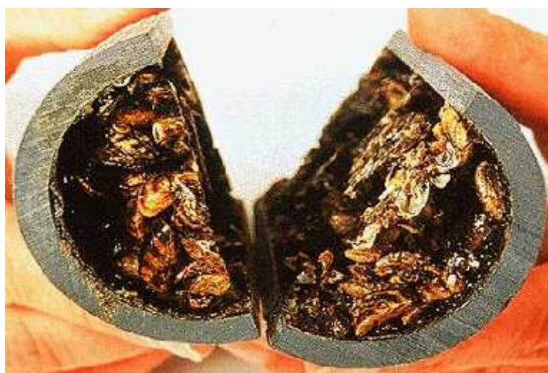
Slika 3. Obraštaj vrste D. polymorpha unutar vodovodnih cijevi
