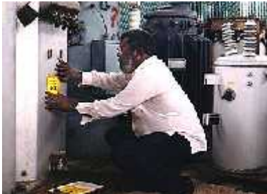
Slika 4.: Označavanje električnog transformatora koji sadrži PCB
