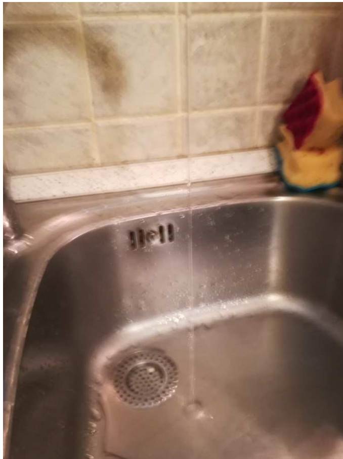
Slika 5.2: Ravan mlaz vode
