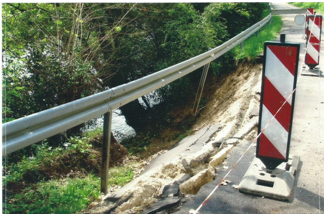
Sl. 29. Klizište uz Dobru na županijskoj cesti 3144 kod Tomašnice Izvor: ŽUC
