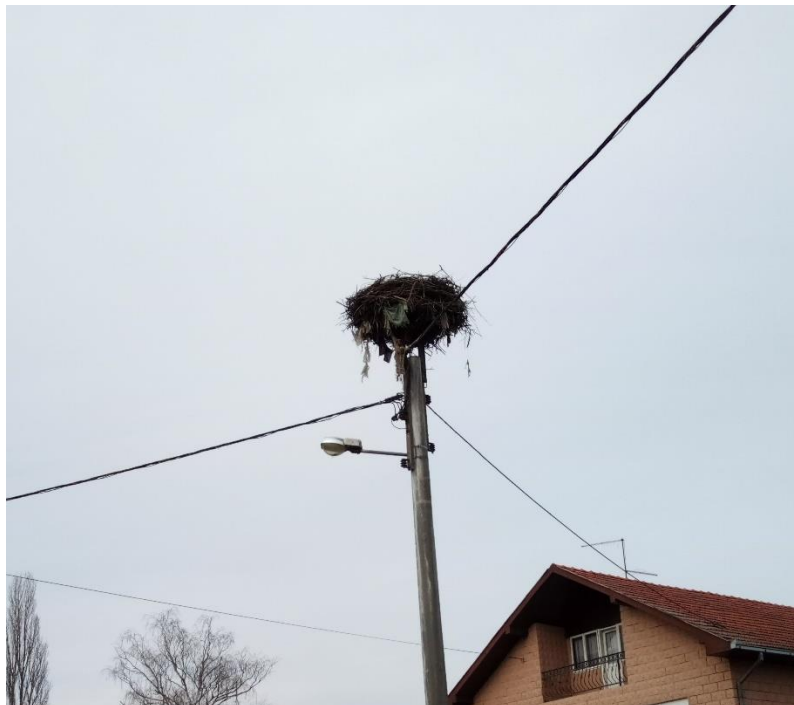
Slika 6. Platforma za gnijezdo (niskonaponska mreža)
