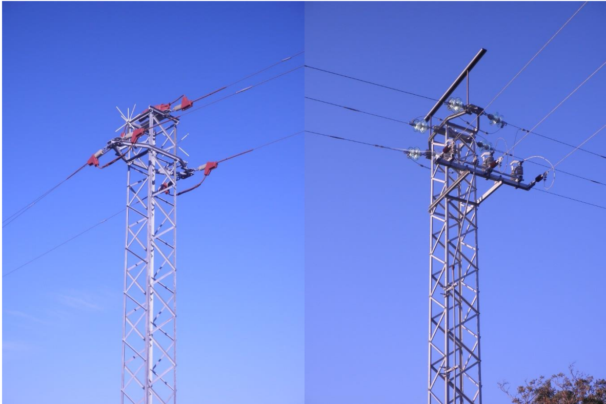
Slika 5. Stup s izolacijom na strujnim mostovima i barijerama za onemogućivanje slijetanja (lijevo) i stup s prečkom za slijetanje (desno)
