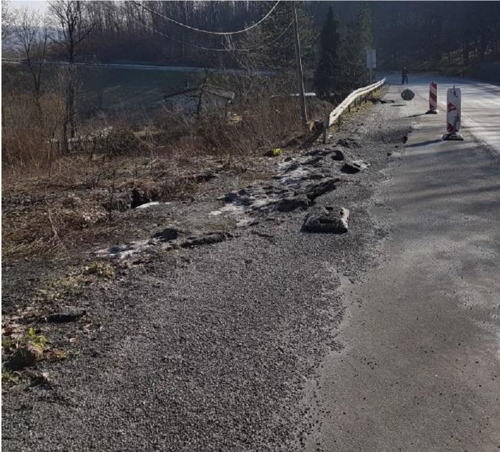
Slika 4.4.2. Klizište na cesti D37, Selište, Petrinja
