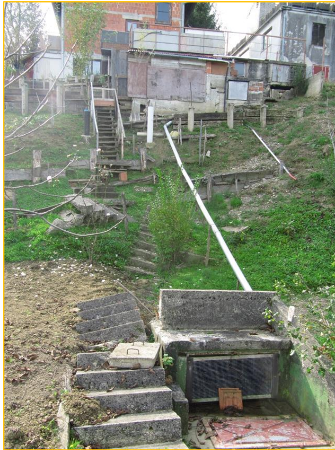
Slika 27. Oštećeni kaptirani zdenac, „proklizale stepenice“ i cijevi koje odводе oborinske vode u tijelo padine (fotografirano tijekom terenskog kartiranja 2020. godine).
