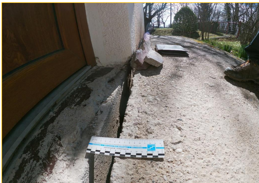
Slika 41. Mjerenje pukotine D4c (ožujak 2020. godine).
