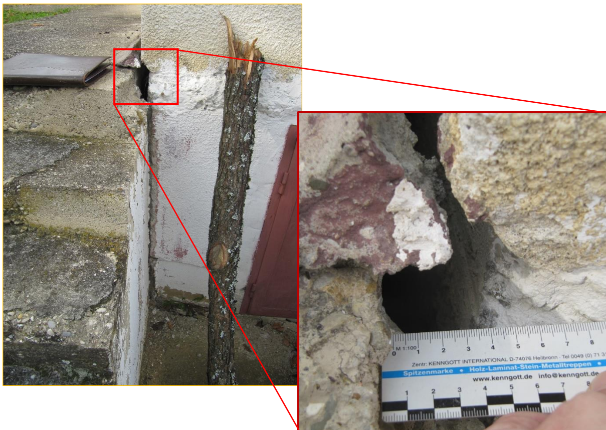
Slika 40. Prvo mjerenje pukotine D4b (listopad 2019. godine).
