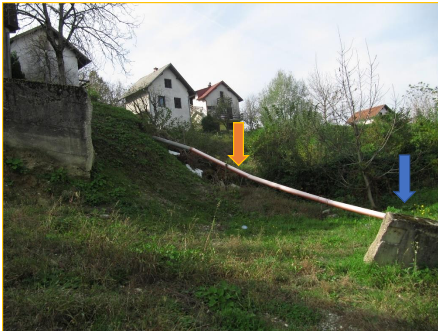
Slika 28. Puknuti zid i proklizali dijelovi - 5 m (plava strelica), te odvodna cijev koja završava u tijelu klizišta (narančasta strelica, fotografirano tijekom terenskog kartiranja 2020. godine).
