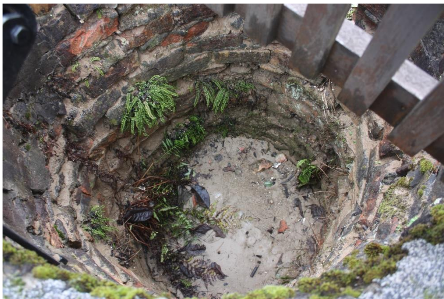
Slika 5. Bunar zatrpan sedimentom na lokaciji S66_1.
