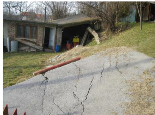
Slika 9. Oštećenja nastala uslijed kretanja klizišta Kostanjek
