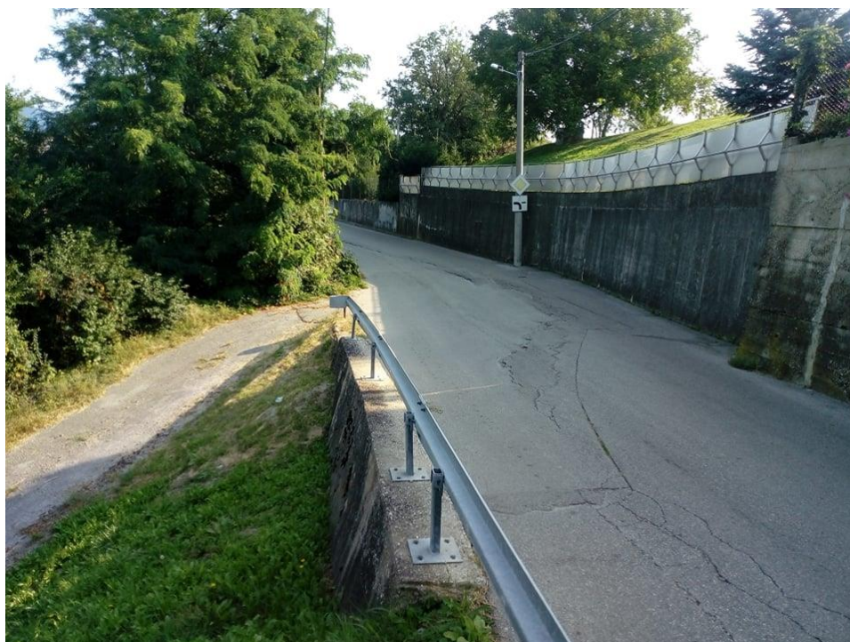
Slika 1.1.. Klizište na samoj ulici Perjavica kod kućnog broja 122
