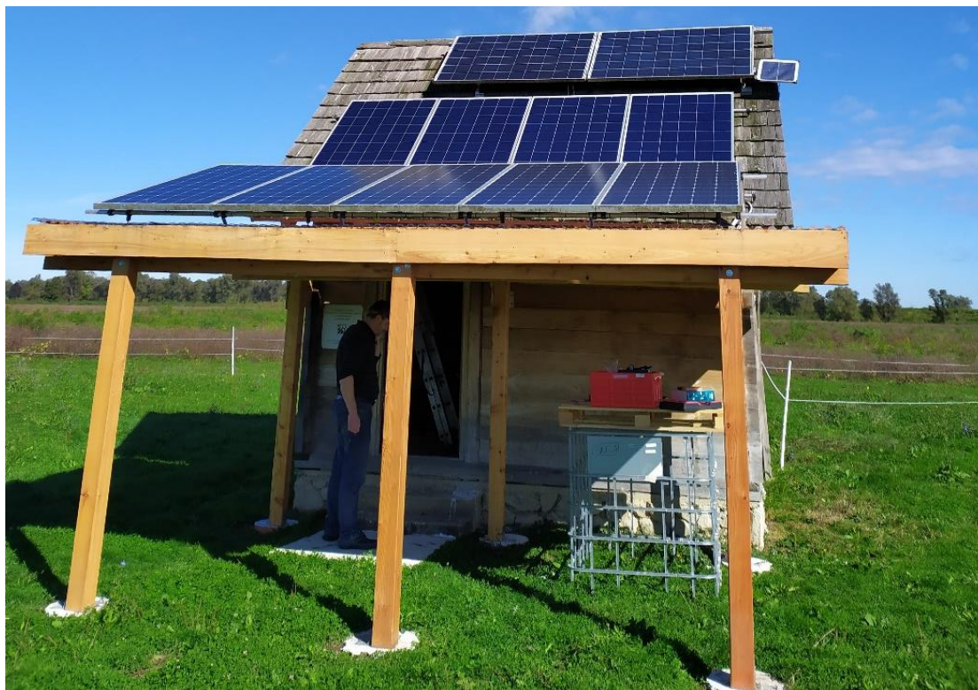
Slika 1.3 – Solarni paneli na krovu kontrolne kuće.
