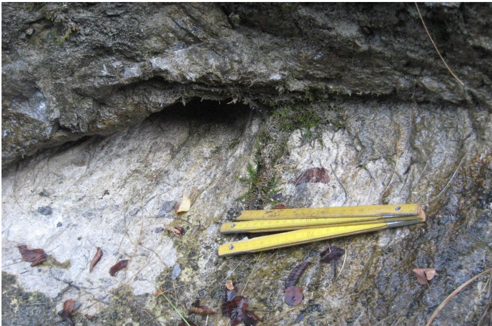
Sl. 15. Pukotina u stijeni
