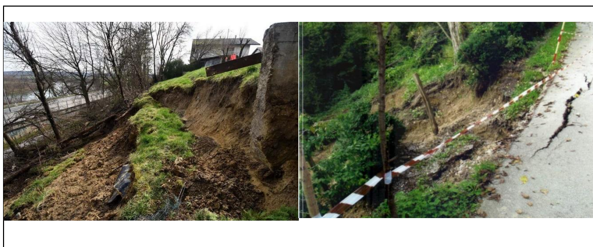
Sl. 26. Klizišta uz prometnice u ulici Udbinja (lijevo) i na lokalnoj cesti 34004 u blizini naselja Kašt (desno)
