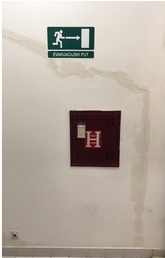
Slika 4.4: Pukotine u podrumu zgrade Geofizičkog odsjeka, ispred prostorije 115, površinski zatvorene uslijed reparacije.
