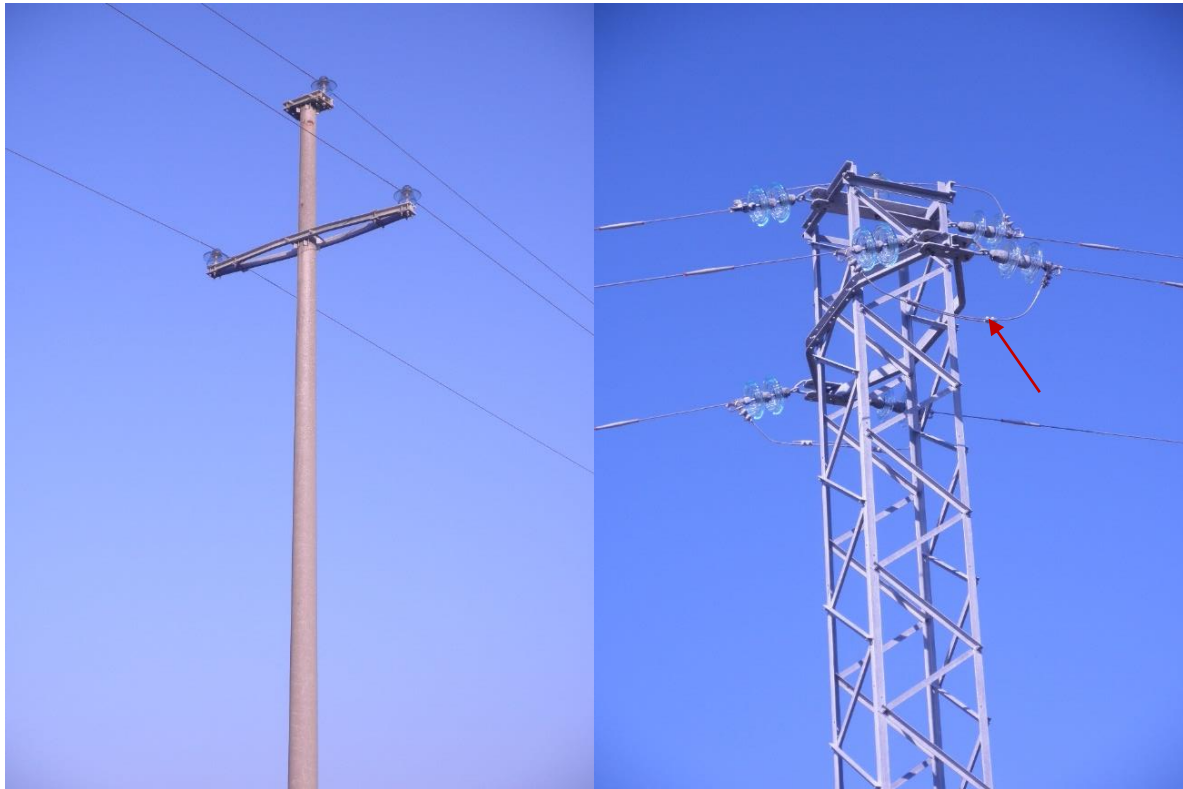
Slika 2. Nosni armirano-betonski stup s potpornim izolatorima (lijevo), zatezni čelično-rešetkasti stup sa strujnim mostovima (strelica) i ovjesnim izolatorima (desno)
