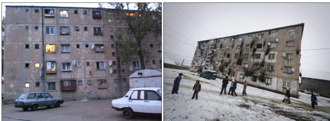
Slika 52. Stanje stambenih objekata koje upućuje na nizak standard stanovanja u Rumunjskoj
