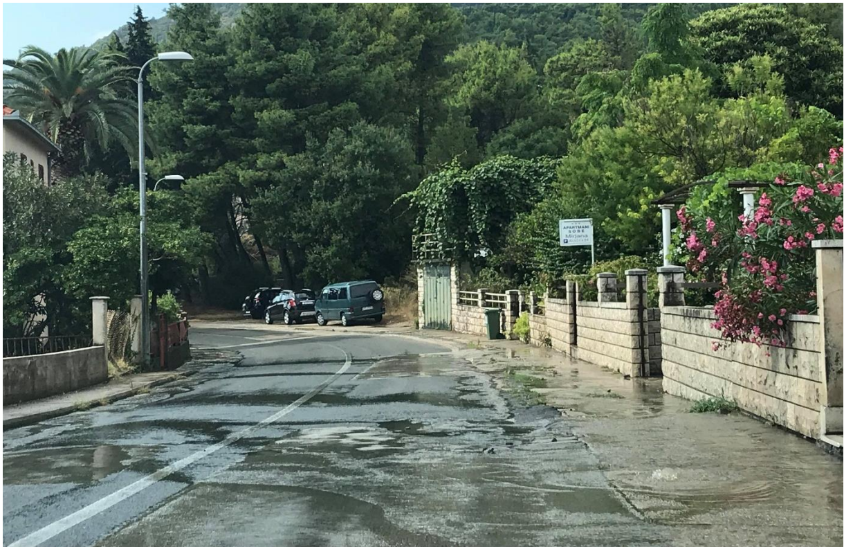
Sl. 10. Loše stanje ceste D-414 u Orebiću
