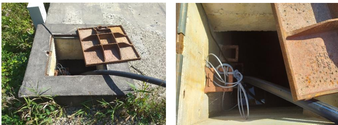
Slika 11a. i 11b. Sabirni bazen za procjedne vode odlagališta otpada Gorjak
