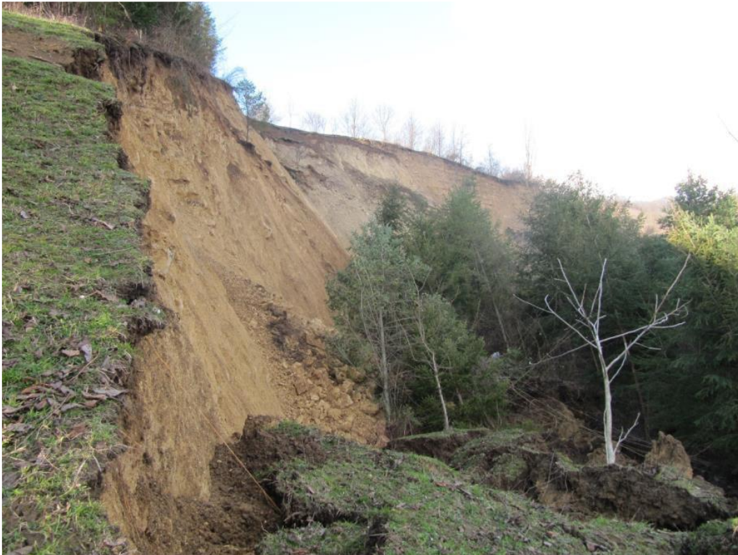
Slika 4.2.4. Glavna pukotina klizišta Kubarnovo brdo dosiže visinu od 30 m na najvišim dijelovima (Podolszki, 2018)
