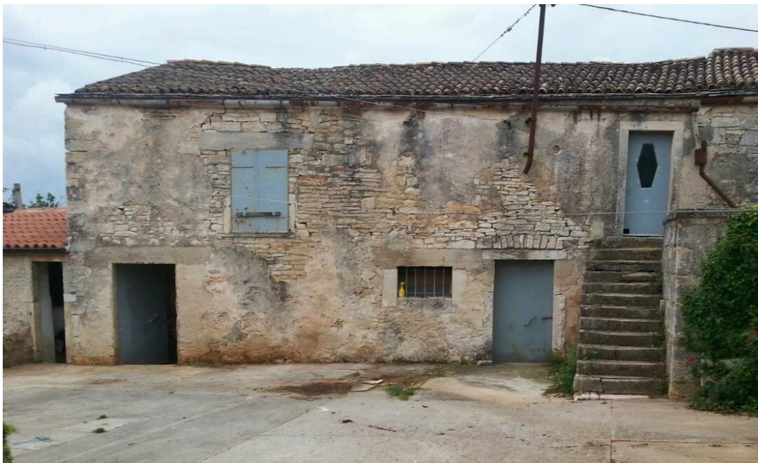
Sl. 24. Primjer opadanja fasadnog pokrova sa stare istarske kuće Izvor: autorica
