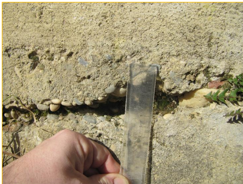
Slika 34. Drugo mjerenje zijeva pukotine D1 - pukotina do 5 cm (ožujak 2020. godine).
