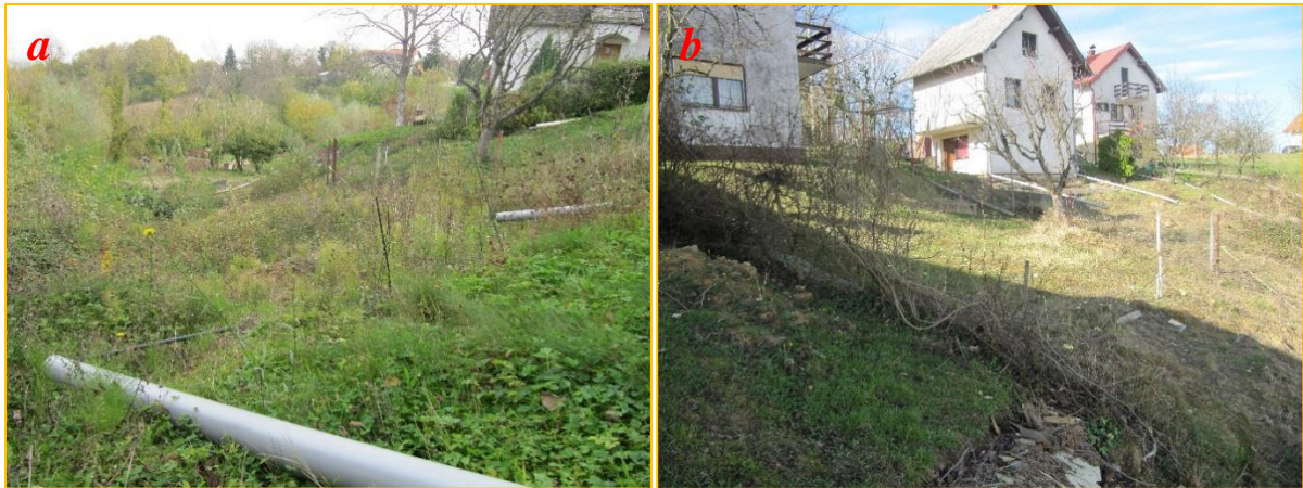
Slika 52. Postojeće (loše) rješenje odvodnje s lokalnih kuća – izravno u tijelo klizišta natapanjem glavne vlačne pukotine: a ) pogled prema istoku (prema k.br. 31); b ) pogled prema zapadu (prema k.br. 23).
