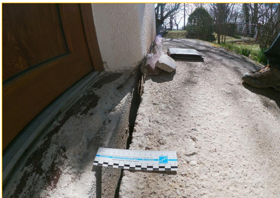
Slika 41. Mjerenje pukotine D4c (ožujak 2020. godine).
