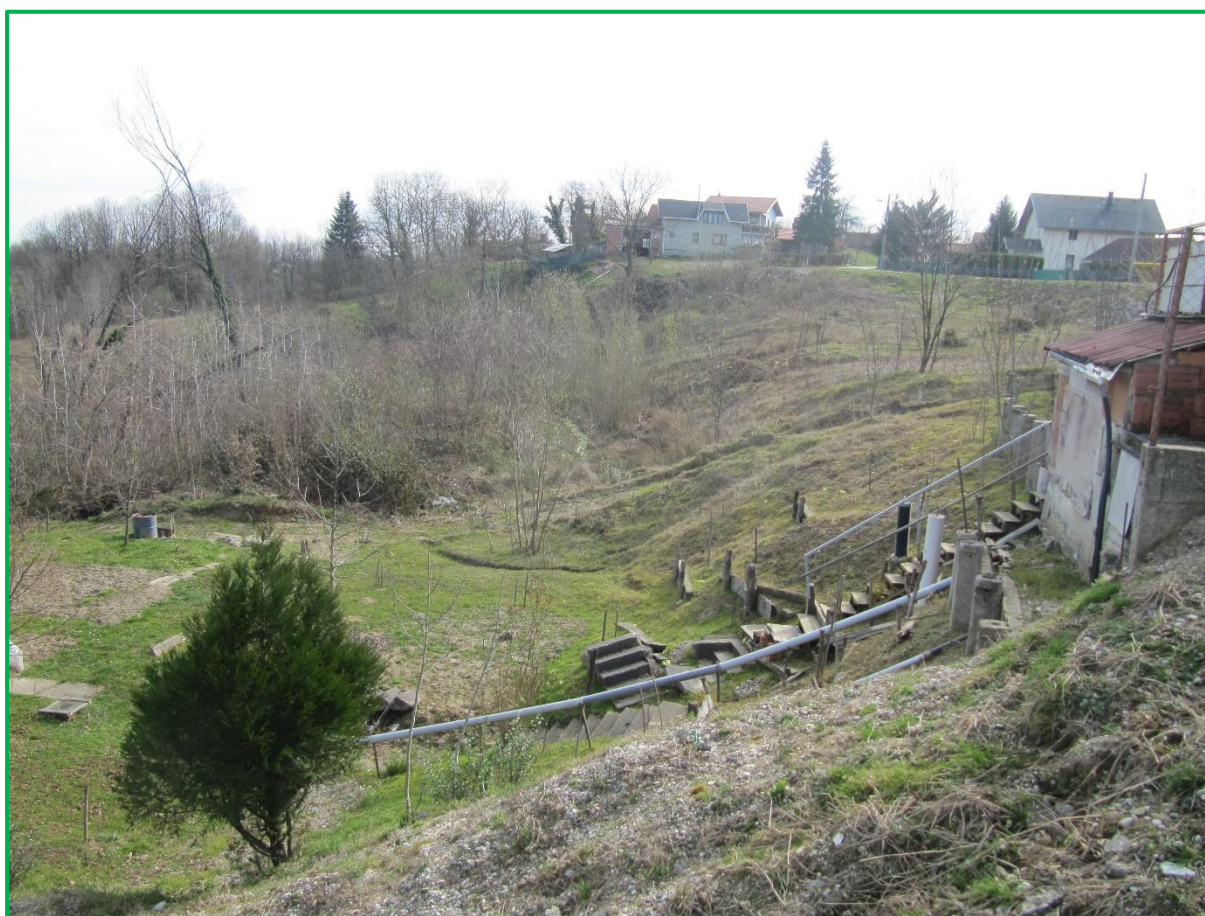
Slika 15. Pogled na čeonu dio klizišta: lokalni povremeni izvori su prisutni u proslojcima pijesaka, a na kontaktima vodopropusno/vodonepropusno su izraženi(-ji) i pokreti. Na klizištu je prisutno više kliznih ploha i više generacija pokreta (fotografirano tijekom terenskog kartiranja 2020. godine).
