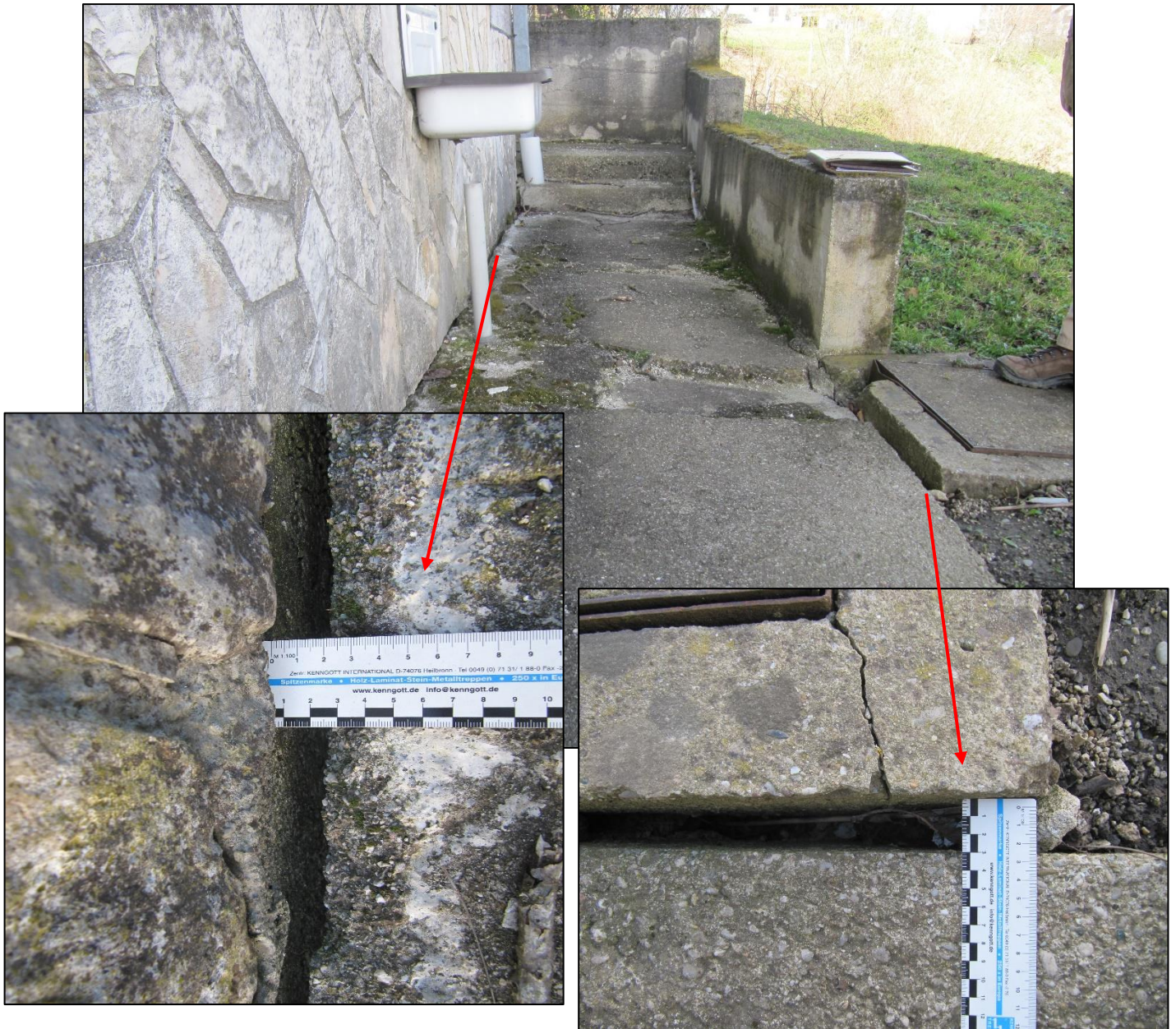
Photo 230,231,8 –do 3 cm novo nastale pukotine uz šaht
