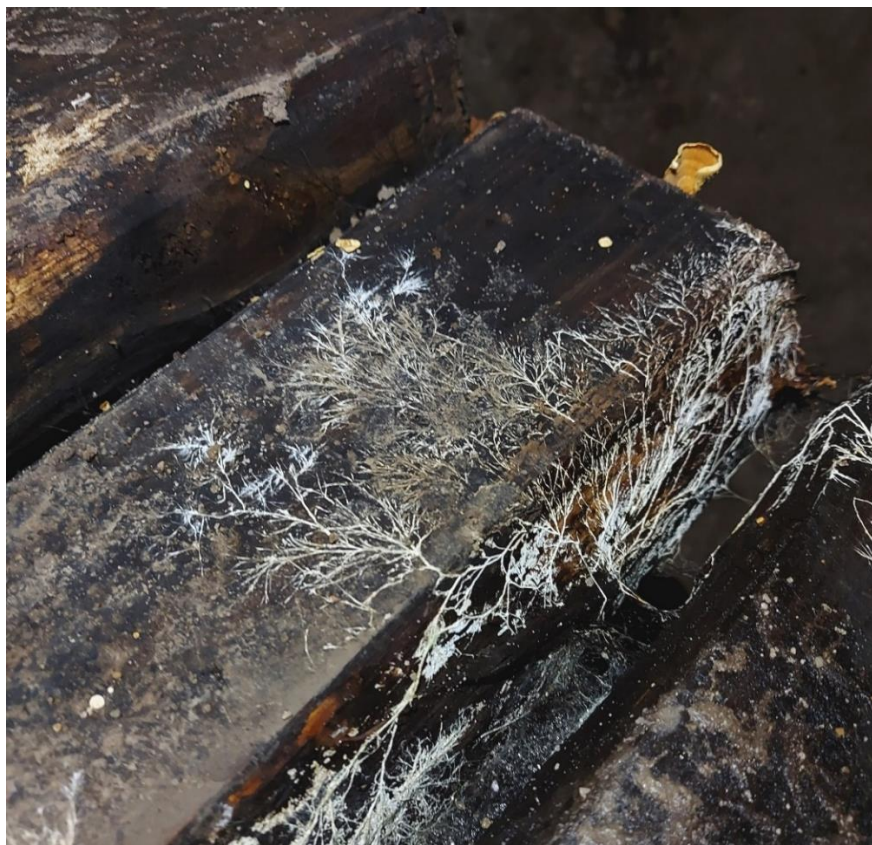
Slika 29 – Plijesan koja se hrani drvnim materijalom na drvenom mostu u Gornjoj Baraćevoj špilji
