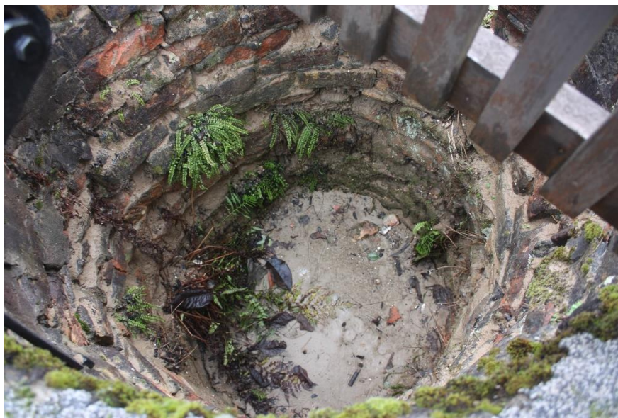
Slika 5. Bunar zatrpan sedimentom na lokaciji S66_1.
