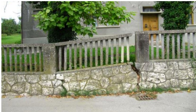
Slika 8. Oštećenja nastala uslijed kretanja klizišta Kostanjek
