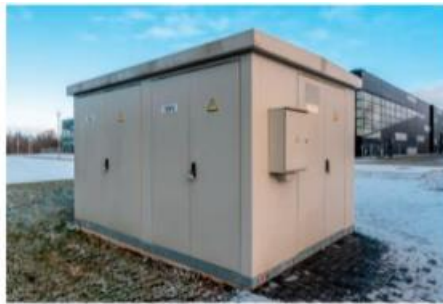
Slika 8.6 Lokalna niskonaponska trafostanica
