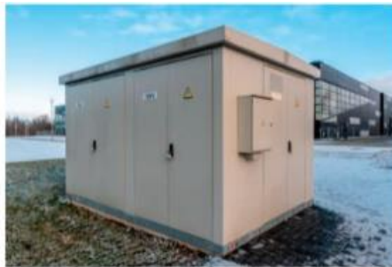
Slika 8.6 Lokalna niskonaponska trafostanica
