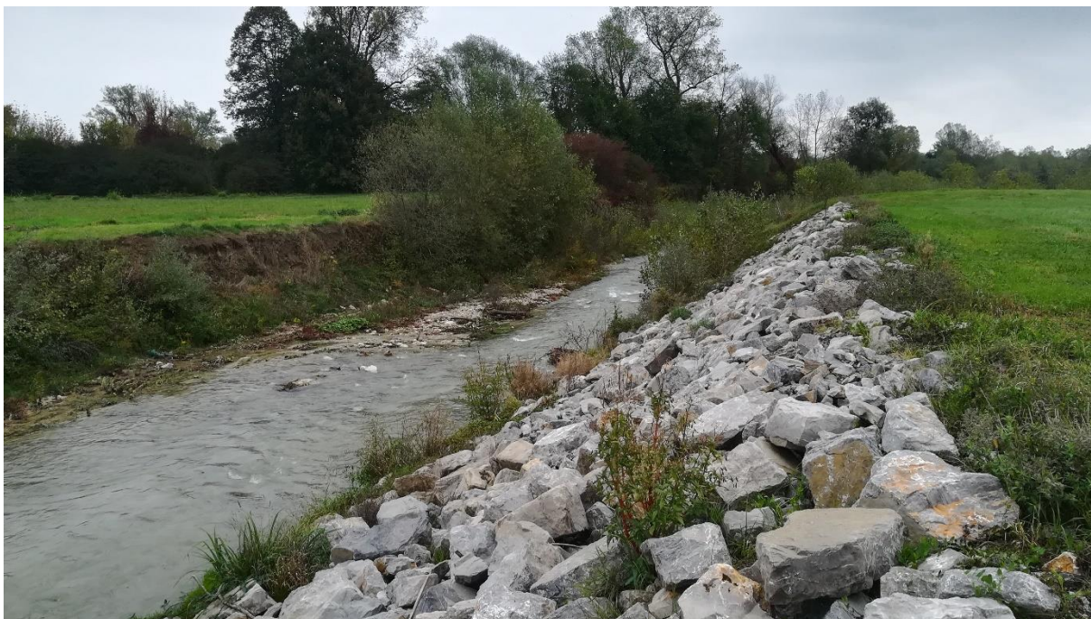
Sl. 28. Kameni nabačaj na desnoj obali Bregane nedaleko ušća u Savu; na lijevoj obali su vidljiva erozijska oštećenja obale (snimila V. Curman, 09.10.2021.)
