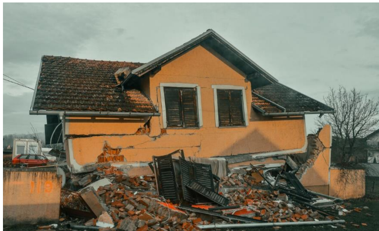
Sl.24. Kuća obnovljena u poslijeratnoj obnovi, stanje nakon petrinjskog potresa 29.12.2020.
