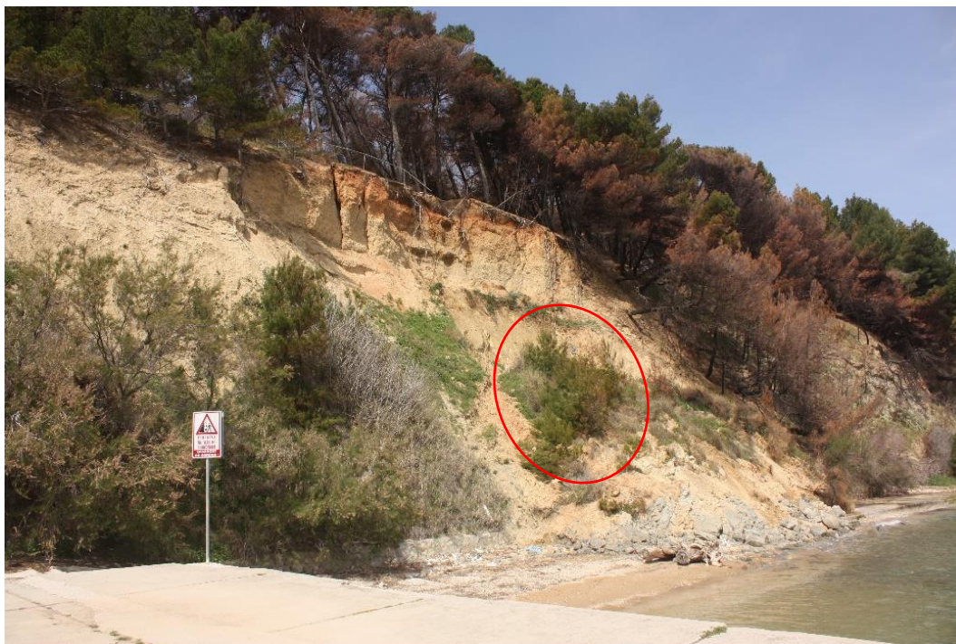
Slika 36. Područje gravitacijskog kretanja materijala na dijelu klifa Duilovo uz betoniranu plažu, travanj 2018.
