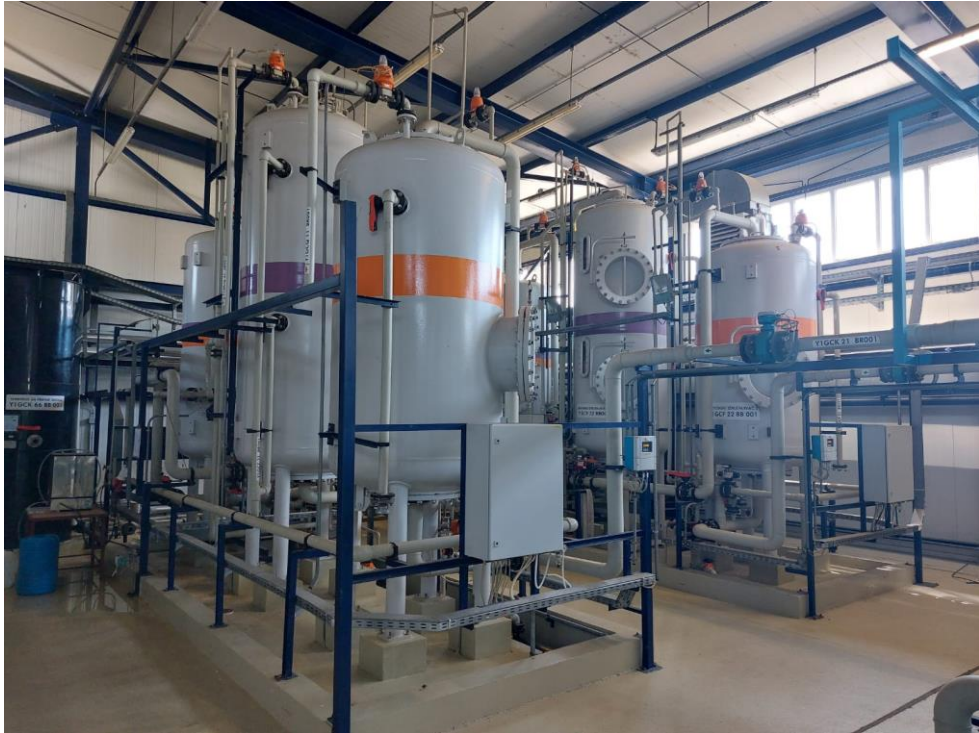
Sl.5. Sustav za ionsku izmjenu vode
