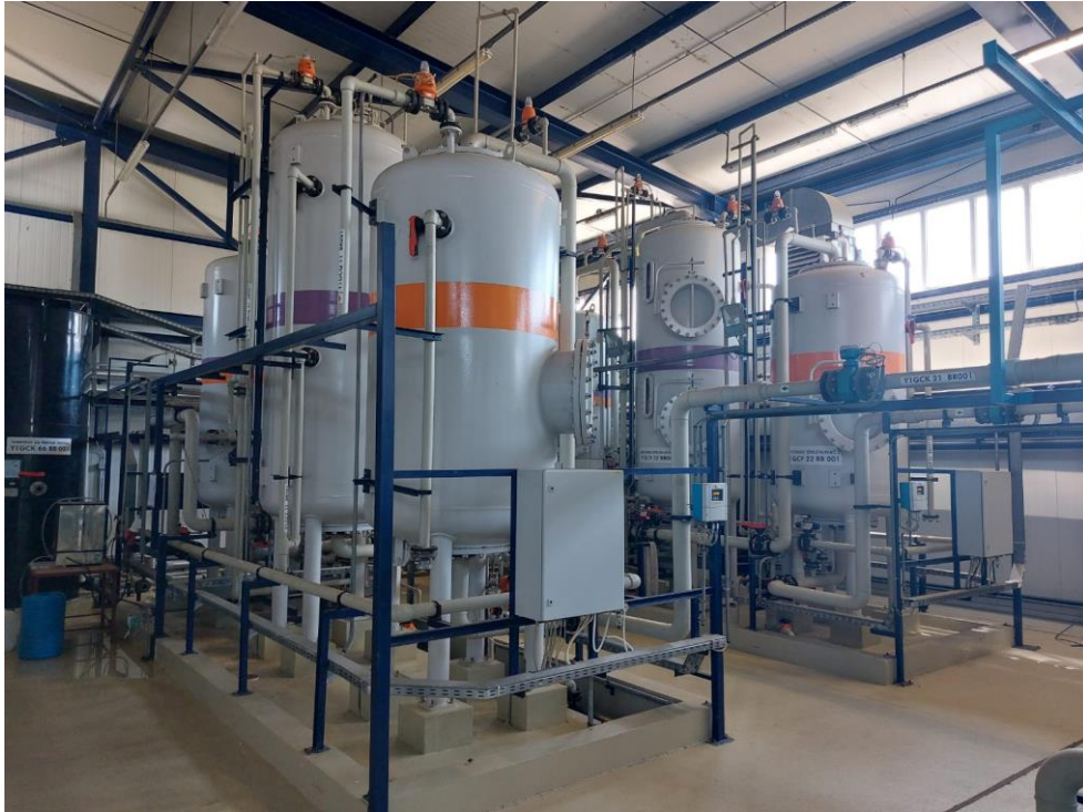
Sl.5. Sustav za ionsku izmjenu vode
