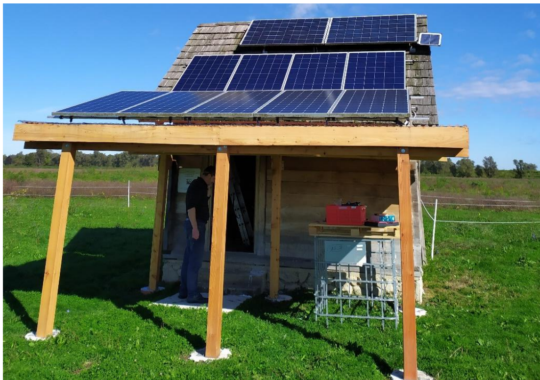
Slika 1.3 – Solarni paneli na krovu kontrolne kuće.
