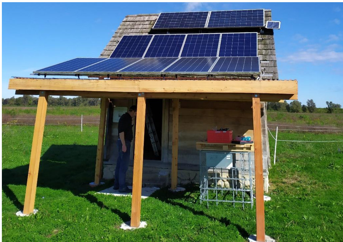
Slika 1.3 – Solarni paneli na krovu kontrolne kuće.
