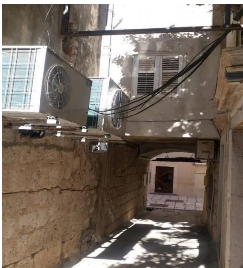
Sl. 20. Primjer neadekvatno postavljenih vanjskih jedinica klima uređaja i kablova
