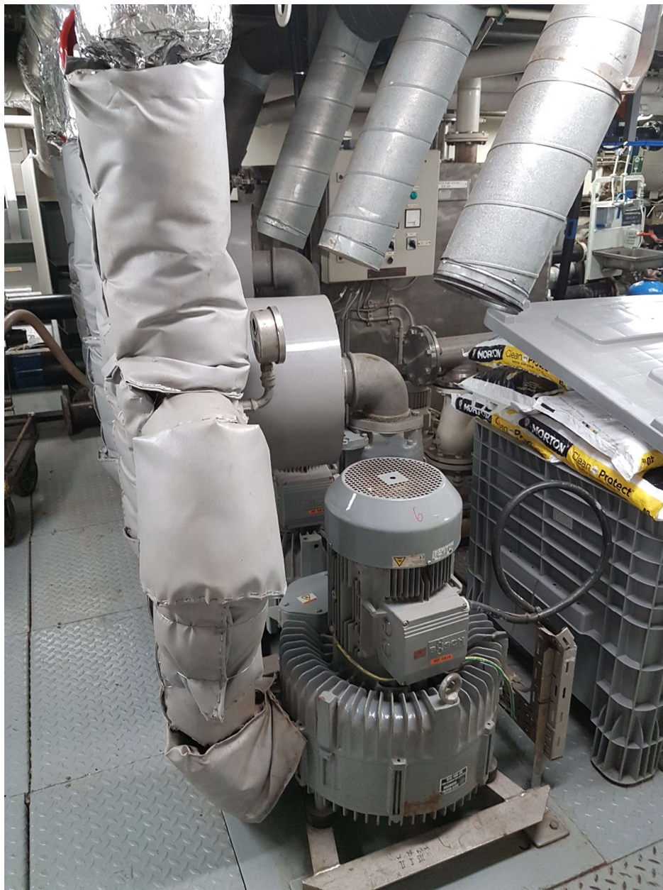
Slika 6.7. Ventilatori za upuhivanje zraka u bio - spremnike; fotografija: Nikola Marvučić
