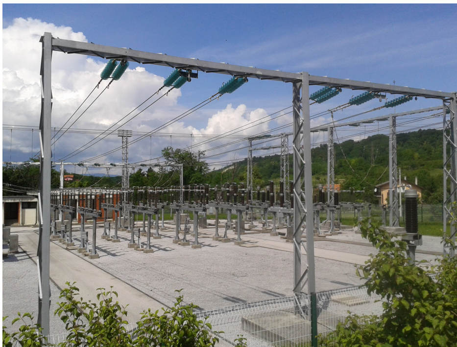
Slika 7: Transformacijsko postrojenje nedaleko od opservatorija.
