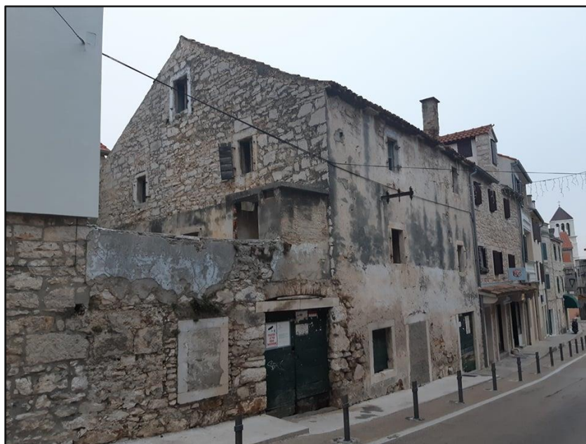
Sl. 14. Autohtona kuća u ruševnom stanju
