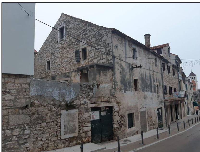
Sl. 14. Autohtona kuća u ruševnom stanju
