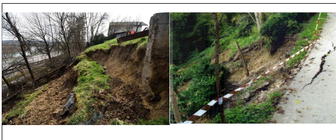
Sl. 26. Klizišta uz prometnice u ulici Udbinja (lijevo) i na lokalnoj cesti 34004 u blizini naselja Kašt (desno)
