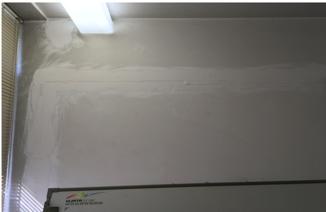
Slika 4.5: Pukotine u prizemlju zgrade Geofizičkog odsjeka u prostoriji 115, površinski zatvorene uslijed reparacije.
