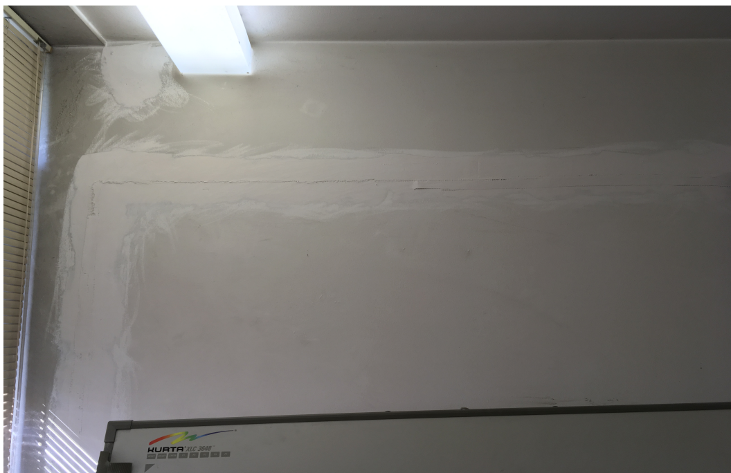
Slika 4.5: Pukotine u prizemlju zgrade Geofizičkog odsjeka u prostoriji 115, površinski zatvorene uslijed reparacije.
