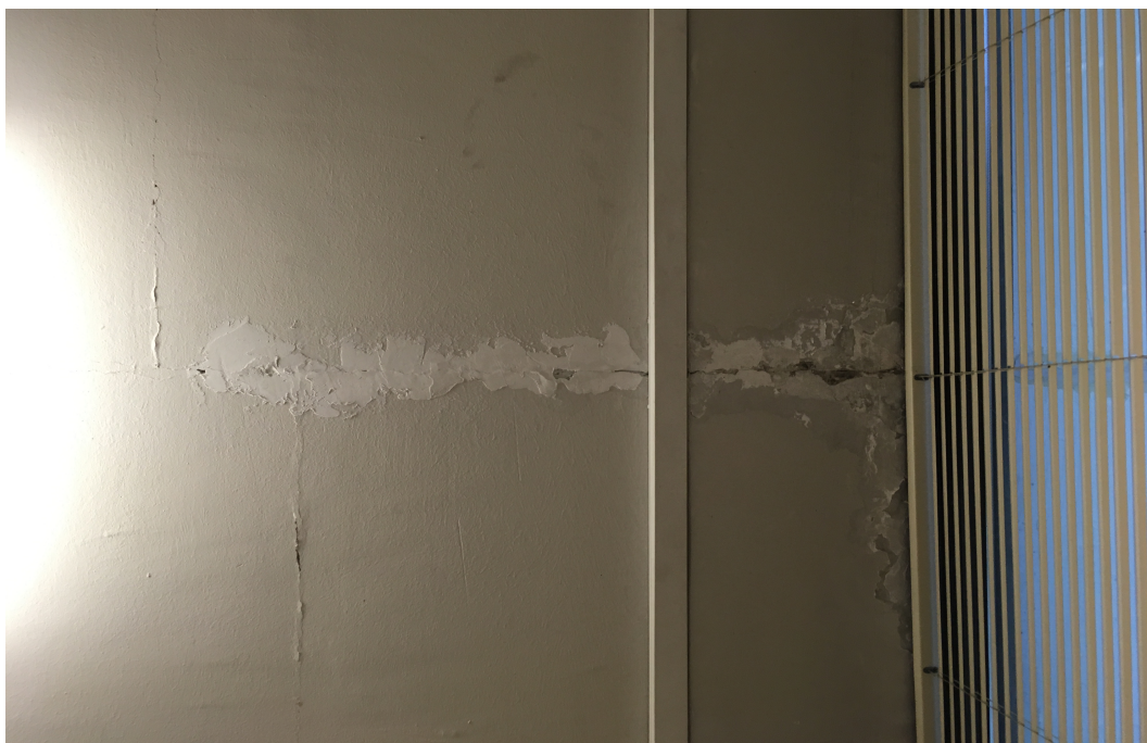
Slika 4.3: Pukotine u prizemlju zgrade Geofizičkog odsjeka, površinski zatvorene uslijed reparacije.
