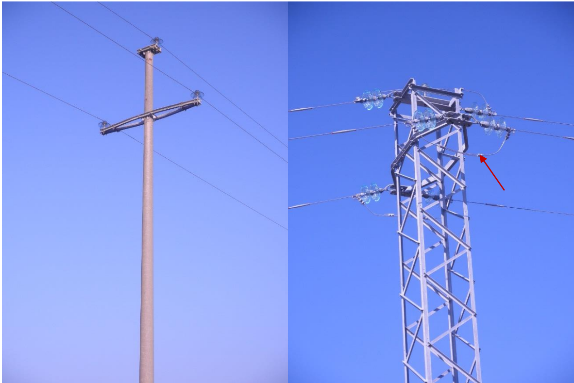
Slika 2. Nosni armirano-betonski stup s potpornim izolatorima (lijevo), zatezni čelično-rešetkasti stup sa strujnim mostovima (strelica) i ovjesnim izolatorima (desno)
