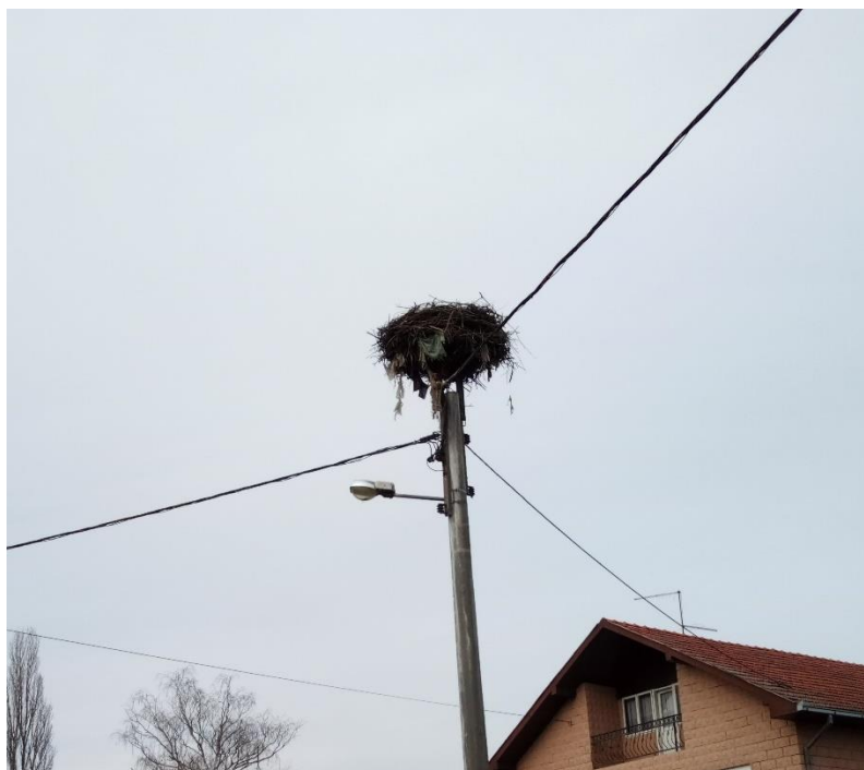
Slika 6. Platforma za gnijezdo (niskonaponska mreža)
